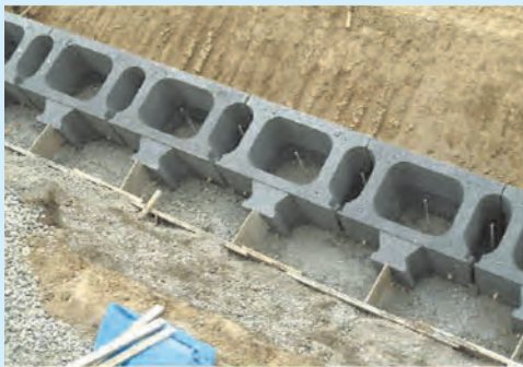
⑤ブロック背面を設計書に基づいた裏込め材料で埋め戻し、ブロック形状・裏込めコンクリートの有無に応じ抜き型枠を設置
